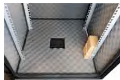
Innenraum ausgekleidet mit Akustikschaum Tür mit Gummidichtung
